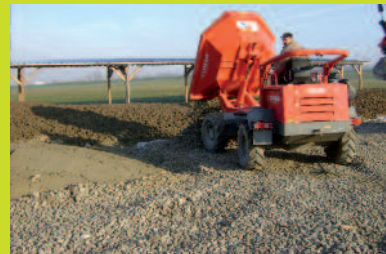
Réalisation d'une piste de chantier en caillou industriel qui servira de couche de forme
